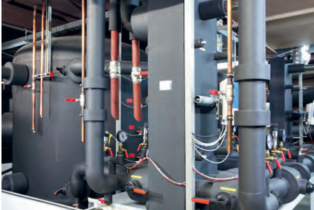
Pilot-Kältespeichersystem mit PCM-Slurry bei ROM Technik in Hamburg. © Rud. Otto Meyer Technik GmbH & Co. KG
